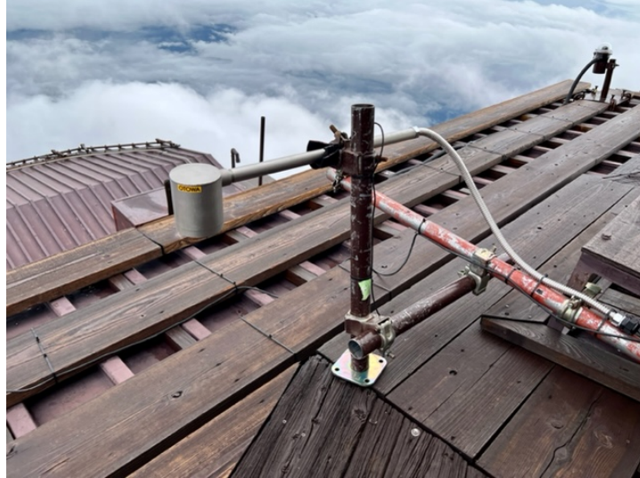
図 1 1号庁舎屋上に設置したフィールドミル
