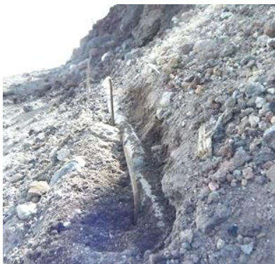
（写真）海底ならぬ海拔3700m付近で土中から露出しているのが発見された送電線ケーブル
