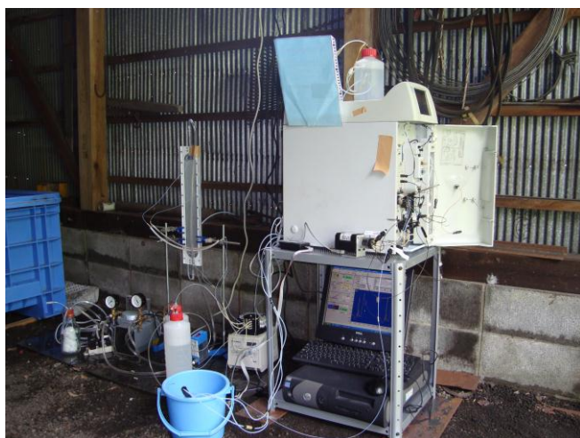
Photo 3 小屋内のガスモニタ
